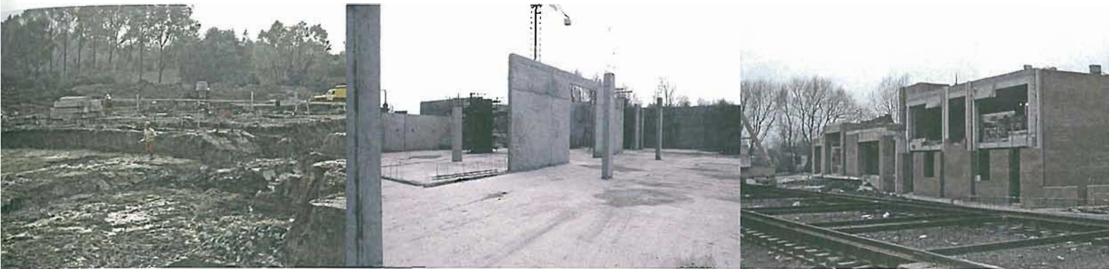
Vues du chantier du musée, fondations du bâtiment est, 31 mai 1981, réserves, 6 mars 1981, logement du conservateur et ateliers d'artistes, 20 février 1982
